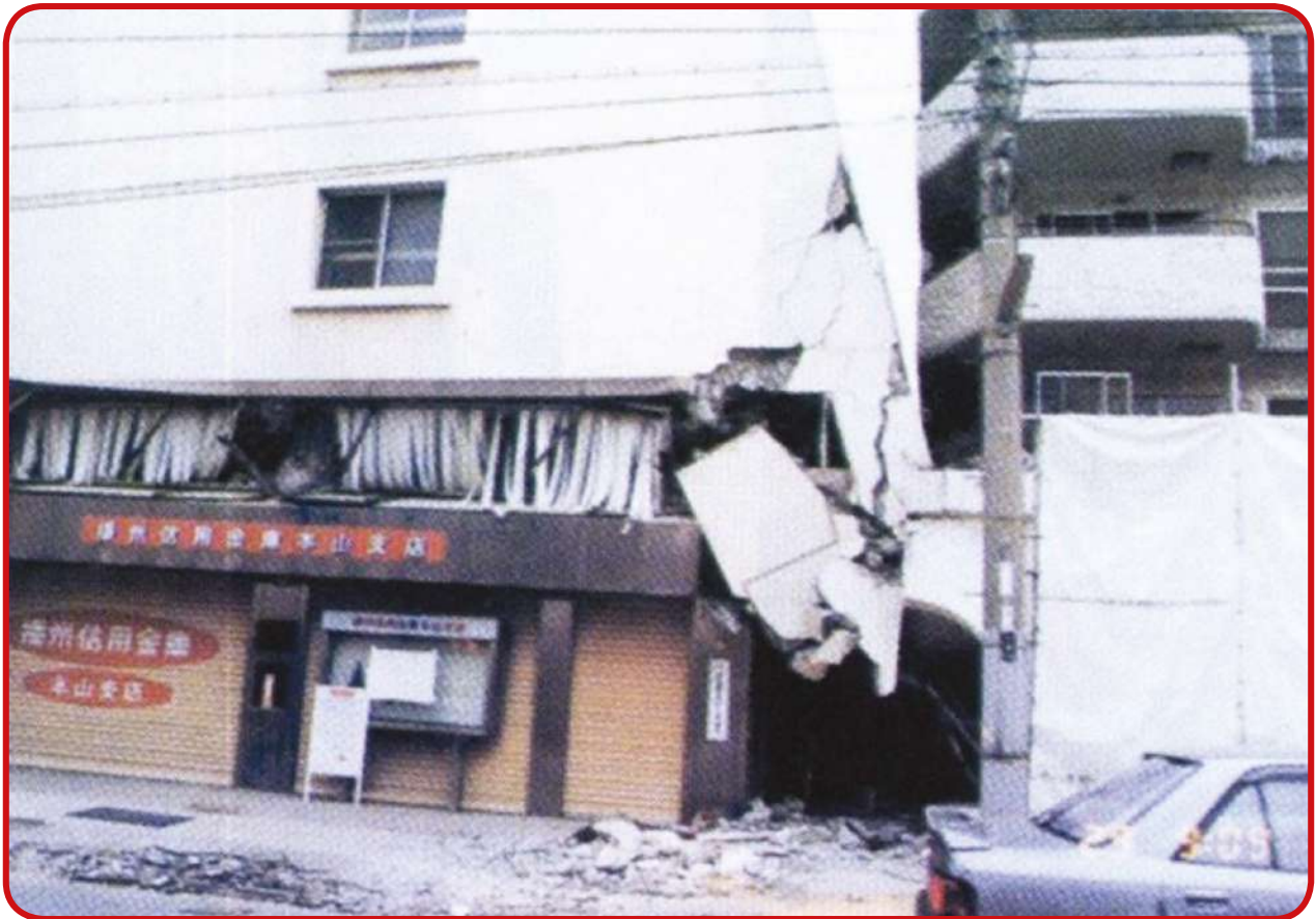
أضرار بسبب تصادم مبنيين مجاورين لقصر المسافة بينهما
