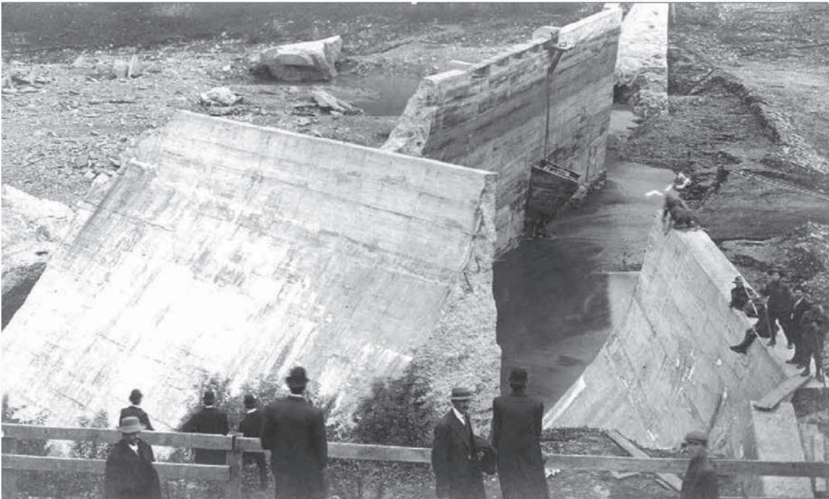
تسبب فشل سد أوستن في عام 1911 في وفاة 78 شخصاً ولا يزال أحد أسوأ حالات فشل السدود في تاريخ الولايات المتحدة الأمريكية.
