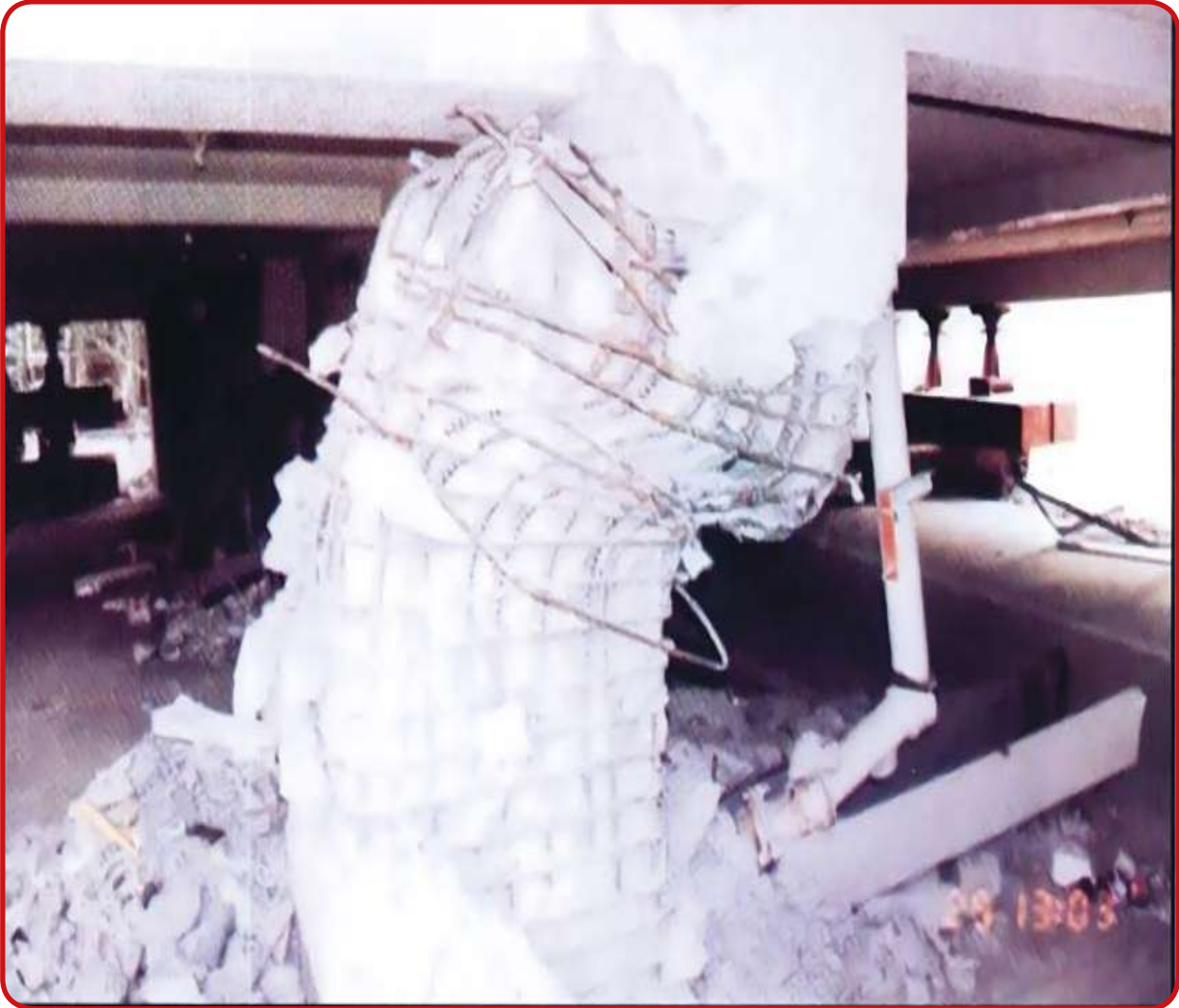
إنهيار رقبة عمود بسبب قوى القص
