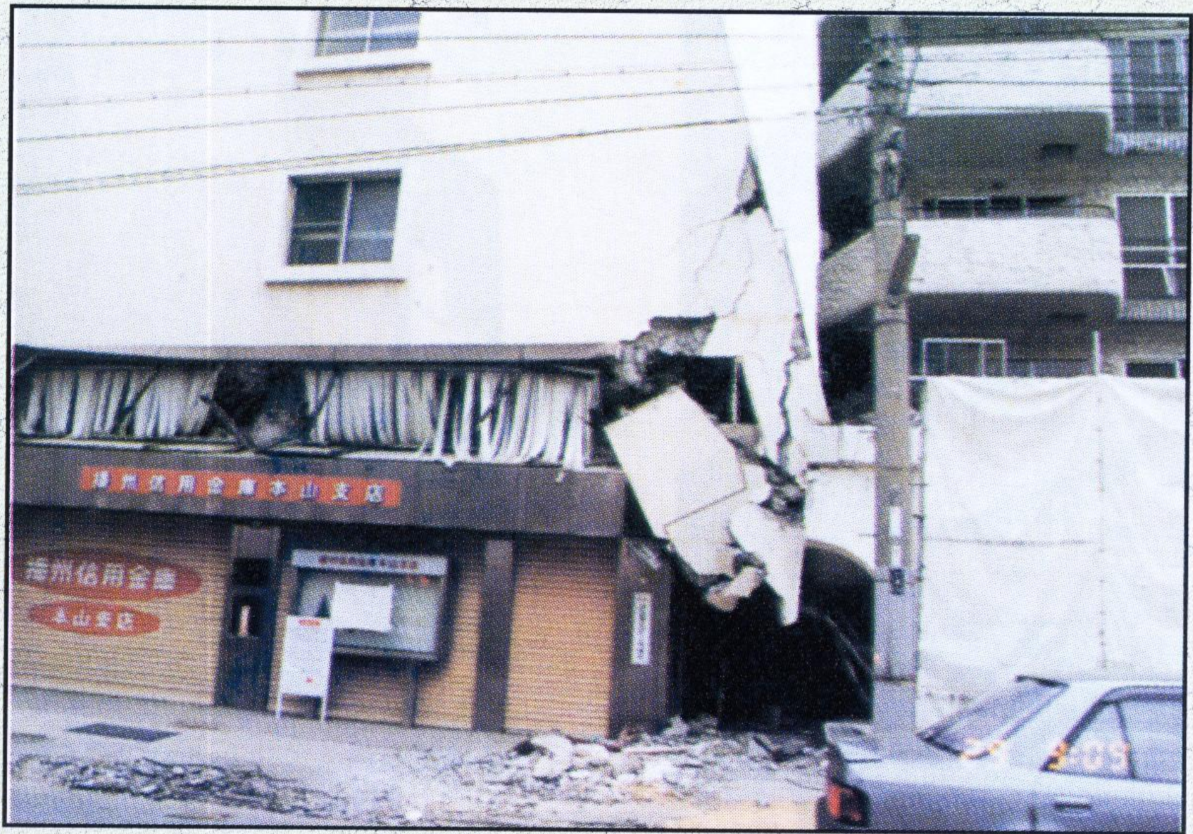
* شكل (٨) أضرار بسبب تصادم مبنيين مجاورين لقصر المسافة بينهما.
